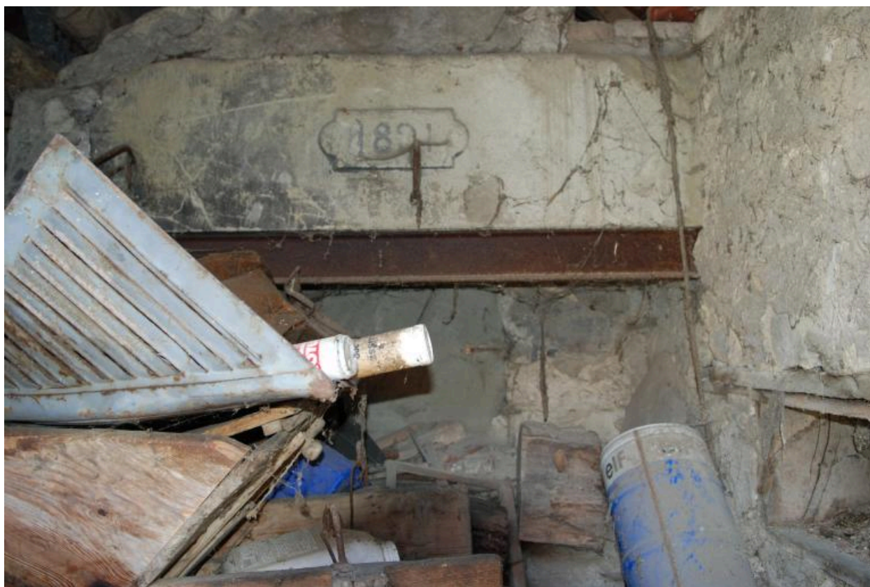
Vue intérieure du four.
