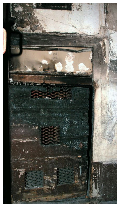
Porte donnant accès à la sous- pente au sud-est de l'allée Phot. Maryannick Chalabi IVR82_20066901362NUCA
