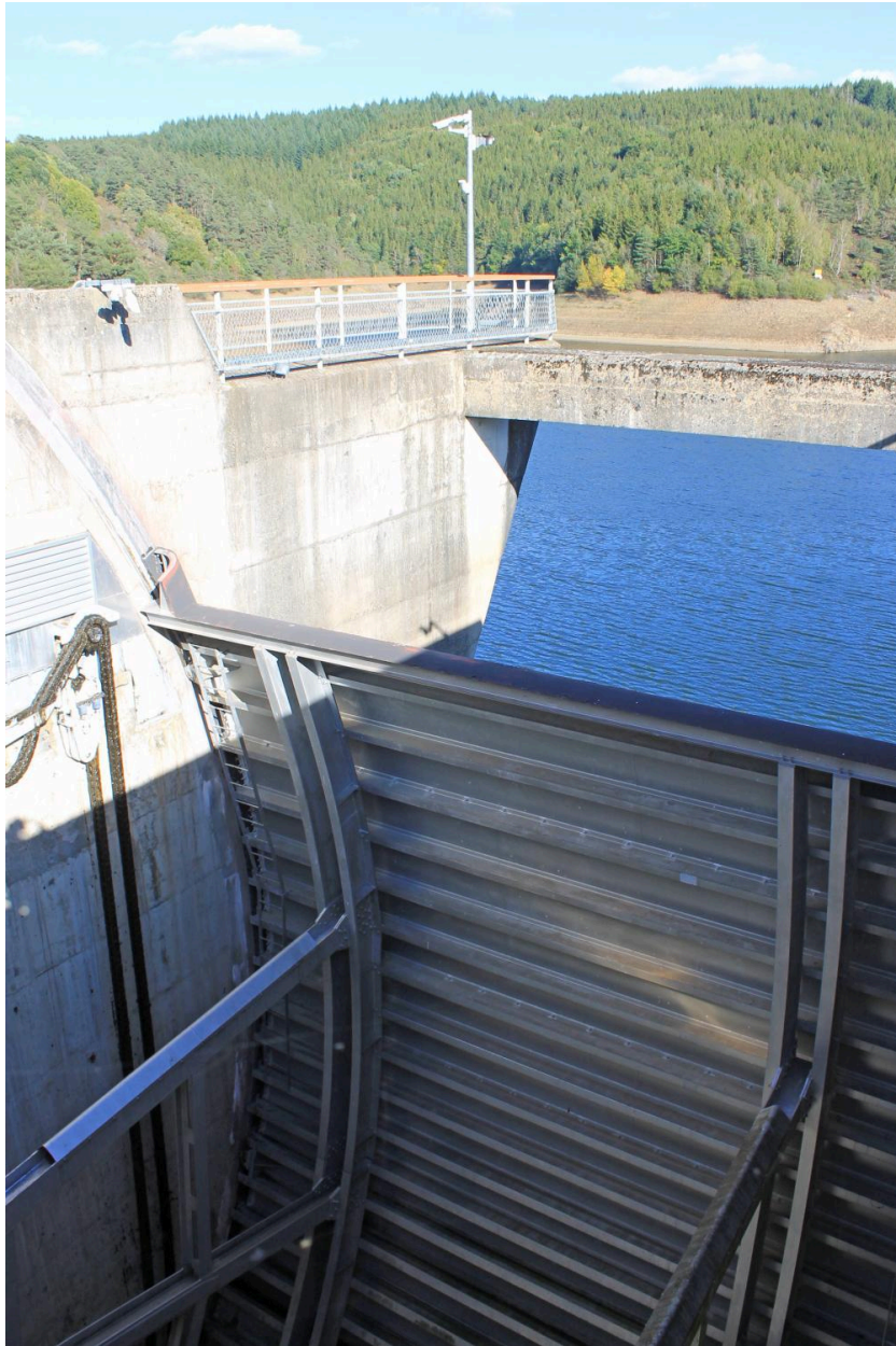
Neuvéglise-sur-Truyère - Fridefont, barrage de Grandval, la vanne de l'évacuateur de crues sud.
