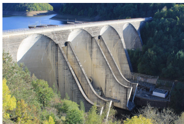
Neuvéglise-sur-Truyère - Fridefont, barrage de Grandval, photographie prise depuis le nord-ouest et montrant le profil en doucine des déversoirs d'évacuation des crues et leur extrémité inférieure en forme de « tremplin de saut à ski ».
