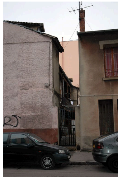
Elévation postérieure avec une coursière en bois à l'étage et WC en pan de bois en bout de coursière, vue depuis la rue Claudius-Penet Phot. Véronique Belle IVR82_20066900815NUCA
