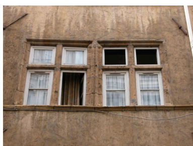
Façade principale rue Dubois, 2e niveau, 1ère et 2e fenêtres Phot. Bernard Ducouret IVR82_20046905743NUCA
