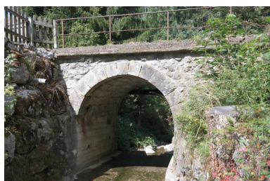
Ponceau de la Plagne, vue de la face amont Phot. Pascale Renard IVR84_20207401032NUCA
