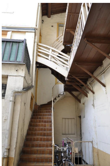
Cour : escalier reliant les deux bâtiments et coursives en bois sur la façade postérieure du bâtiment sur rue Phot. Catherine Guégan IVR84_20176900990NUCA
