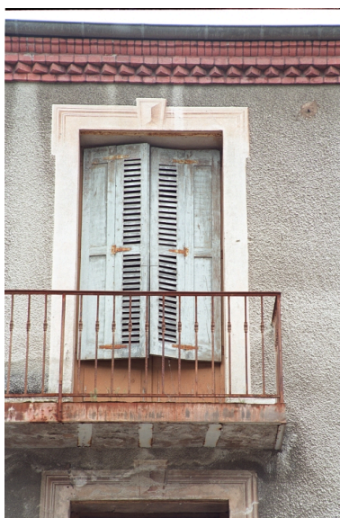
Aux Promenades, maison (1986 B2 901). Bâtiment enduit ciment, décor peint en trompe l'oeil : encadrement mouluré. Détail encadrement peint Phot. Thierry Monnet IVR82_20034200790ZE
