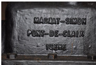
Inscriptions portées à l'alternateur de la turbine Phot. Samir Mahfoudi, Autr. Samir Mahfoudi IVR82_20107403109NUCA
