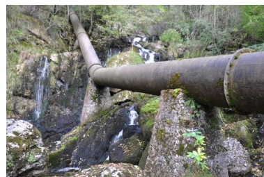
Conduite forcée captant les eaux de la cascade de Morette Phot. Samir Mahfoudi, Autr. Samir Mahfoudi IVR82_20107403104NUCA
