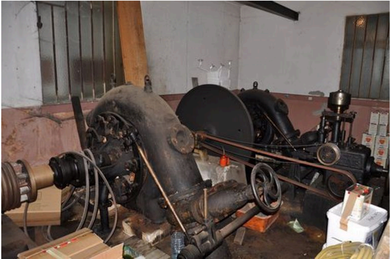
Groupe de deux turbine Magnat-Simon de la centrale hydro-électrique
