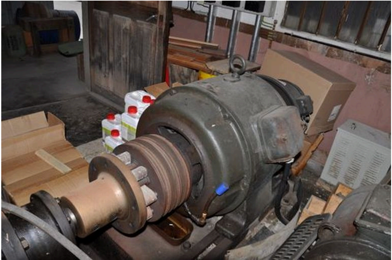
Moteur électrique de l'Entreprise J.L. Matabon
