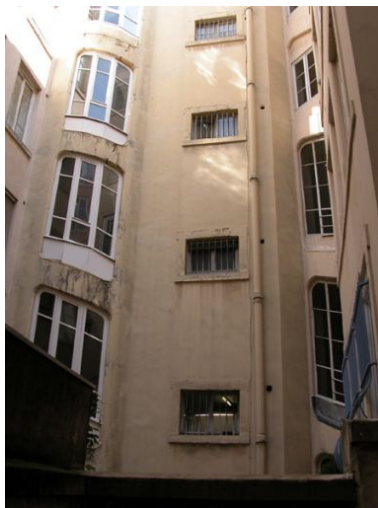
Elévation de la cage d'escalier (à gauche) et du corps adjacent (au centre) sur les cours des immeubles 21, rue Mercière et 20, rue de Brest Phot. Bernard Ducouret IVR82_20046905728NUCA
