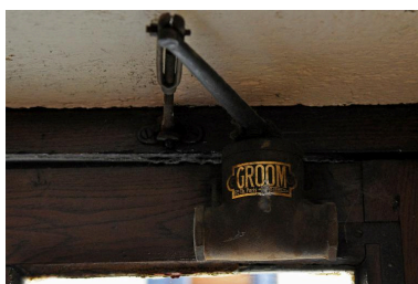
Vue intérieure, détail du groom de la porte de cour Phot. Magali Delavenne IVR84_20176901513NUCA
