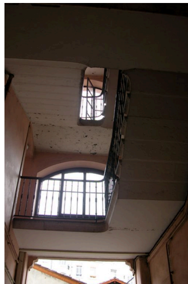
Vue de la cage d'escalier et du passage de l'escalier au- dessus du passage couvert
