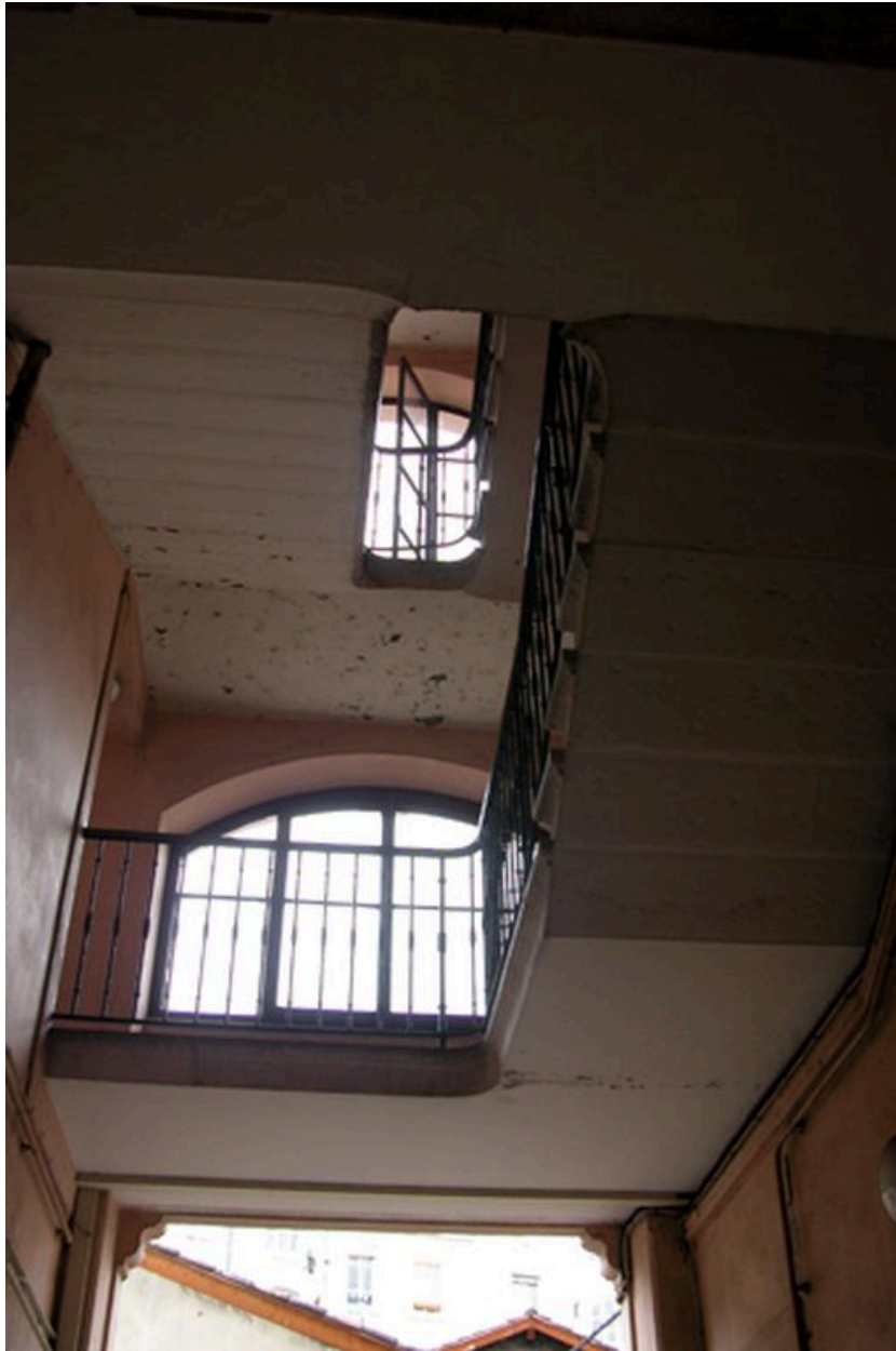
Vue de la cage d'escalier et du passage de l'escalier au-dessus du passage couvert
