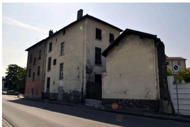
Vue d'ensemble des élévations postérieures, depuis le nord-ouest Phot. Catherine Guégan IVR82_20096903489NUCA
