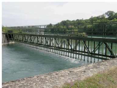
Canal d'amenée d'eau, vue partielle : passerelle (depuis la rive gauche) Phot. I. Havard IVR82_20106902872NUCA
