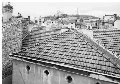
Eglise, toiture, partie couverte par des longs pans Phot. Eric Dessert IVR82_20046900491P
