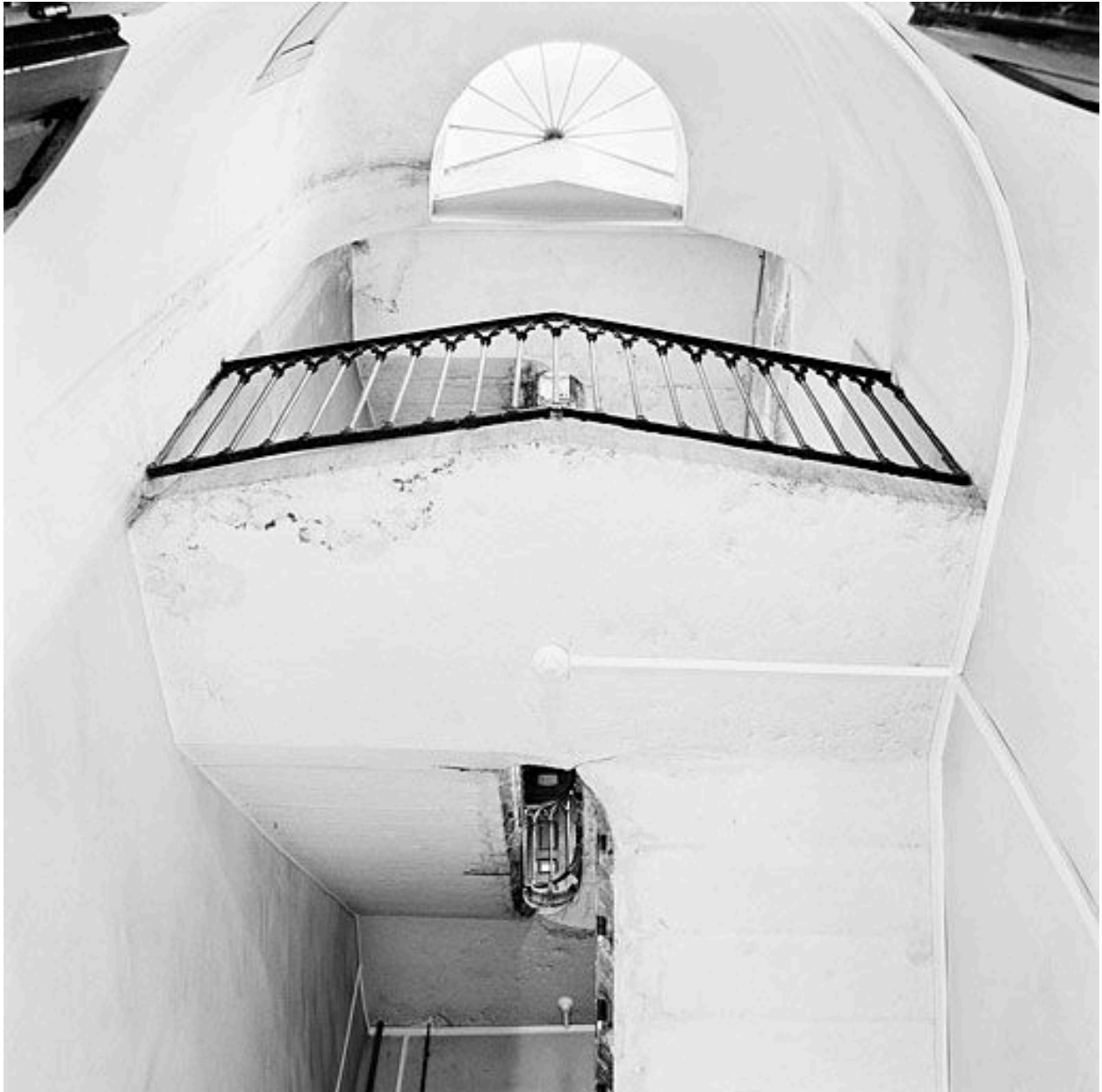
Bâtiment à étages, escalier de droite, repos du premier étage d'escalier et rétrécissement de la cage au-dessus
