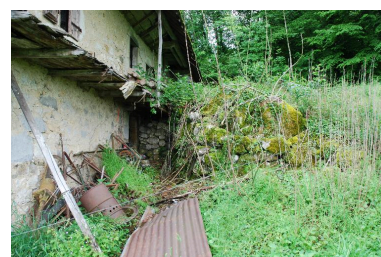
Entrée de la cave située dans la façade latérale droite. Phot. Thierry Monnet IVR82_20157302536NUCA
