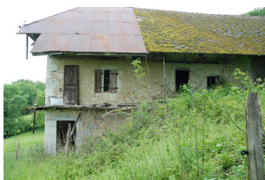
Vue générale de la façade latérale de face. Phot. Thierry Monnet IVR82_20157302535NUCA
