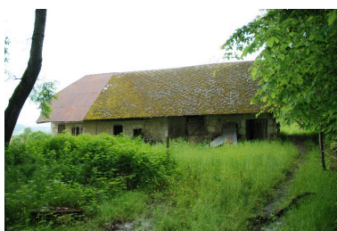
Vue d'ensemble de la façade latérale droite, partie amont avec la grange et l'étable. Phot. Thierry Monnet IVR82_20157302537NUCA
