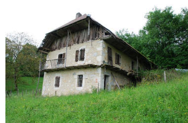
Vue d'ensemble de la ferme de trois quart avant droit. Phot. Thierry Monnet IVR82_20157302533NUCA
