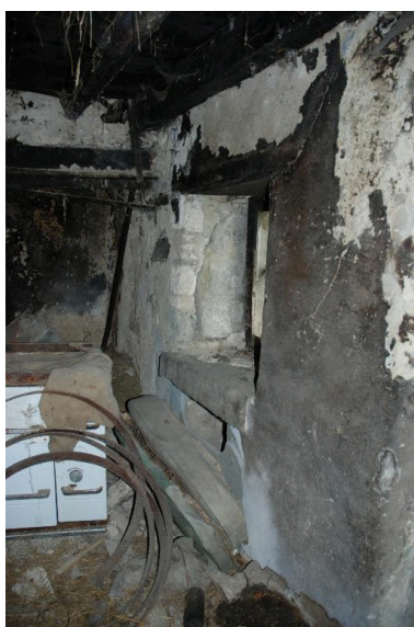
Vue intérieure de la cuisine du logis, potager. Phot. Thierry Monnet IVR82_20157302543NUCA
