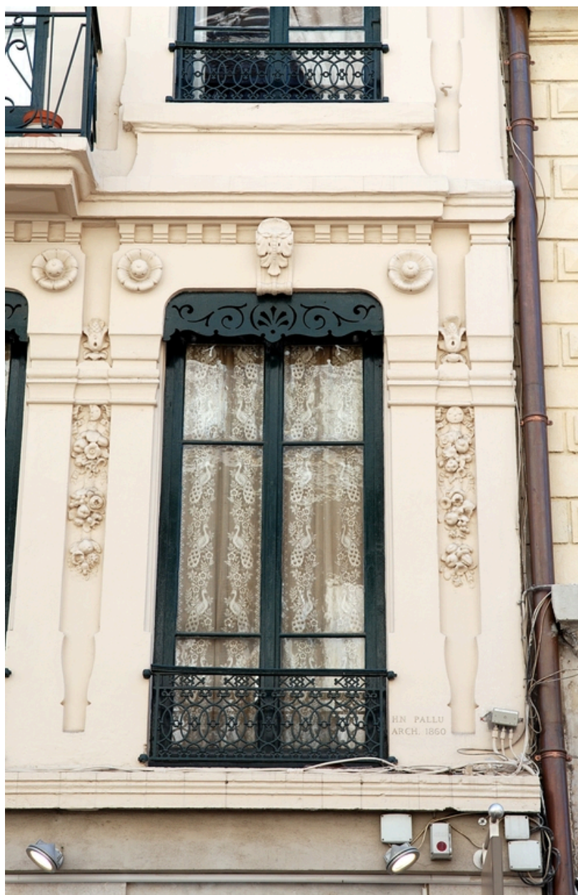
Elévation antérieure : détail d'une baie du premier étage carré et de la signature de l'architecte
