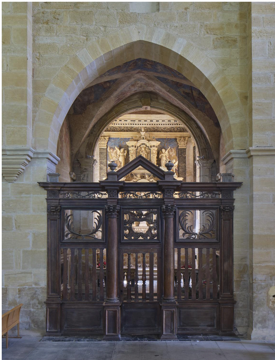
Clôture de la chapelle de Nérestang (classée MH), vue générale depuis la nef
