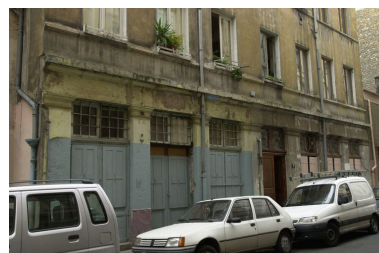
Détail du rez-de-chaussée (boutiques délimitées par des piliers monolithes). Etat en 2002 IVR82_20026902818NUCA
