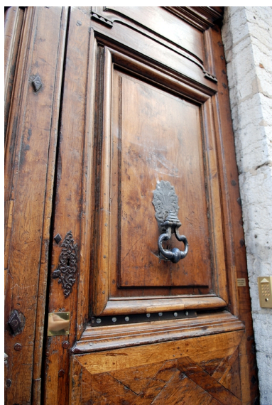
Elévation rue Emile-Zola : détail de la porte cochère Phot. Véronique Belle IVR82_20096904855NUCA
