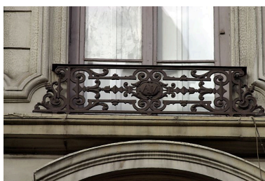
Façade principale, 3e niveau, détail d'un appui de fenêtre Phot. Bernard Ducouret IVR82_20046900276NUCA
