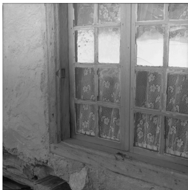
Logis, détail de l'encadrement de la baie à l'étage, trace de croisée en bois. Phot. Jean-Marie Refflé IVR82_20024200965X
