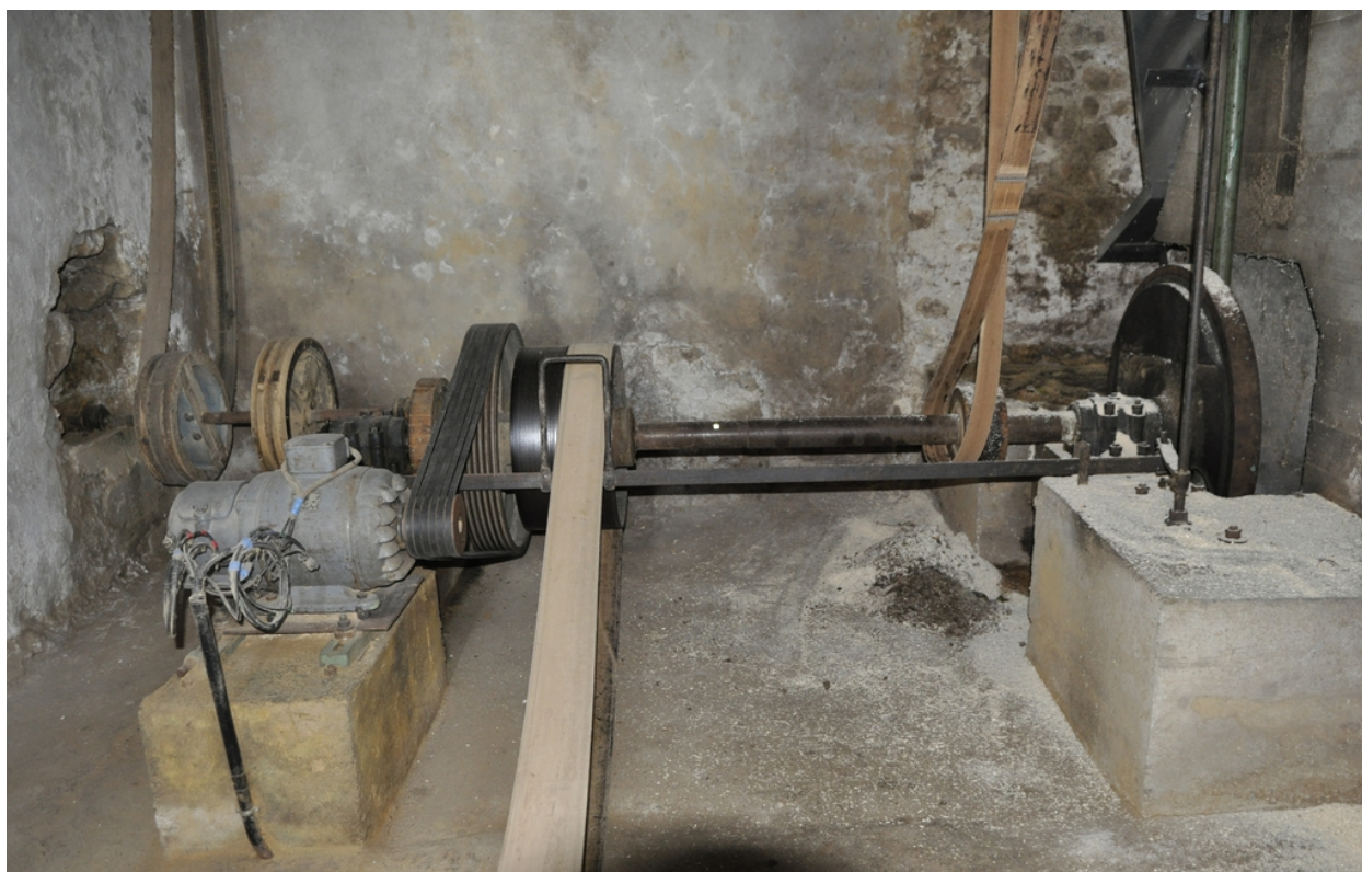
Vue du moteur électrique et des systèmes d'entraînement.
