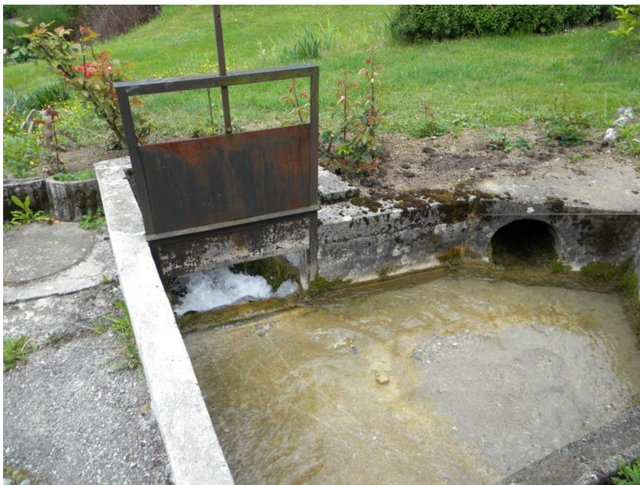
Vue de la prise d'eau.
