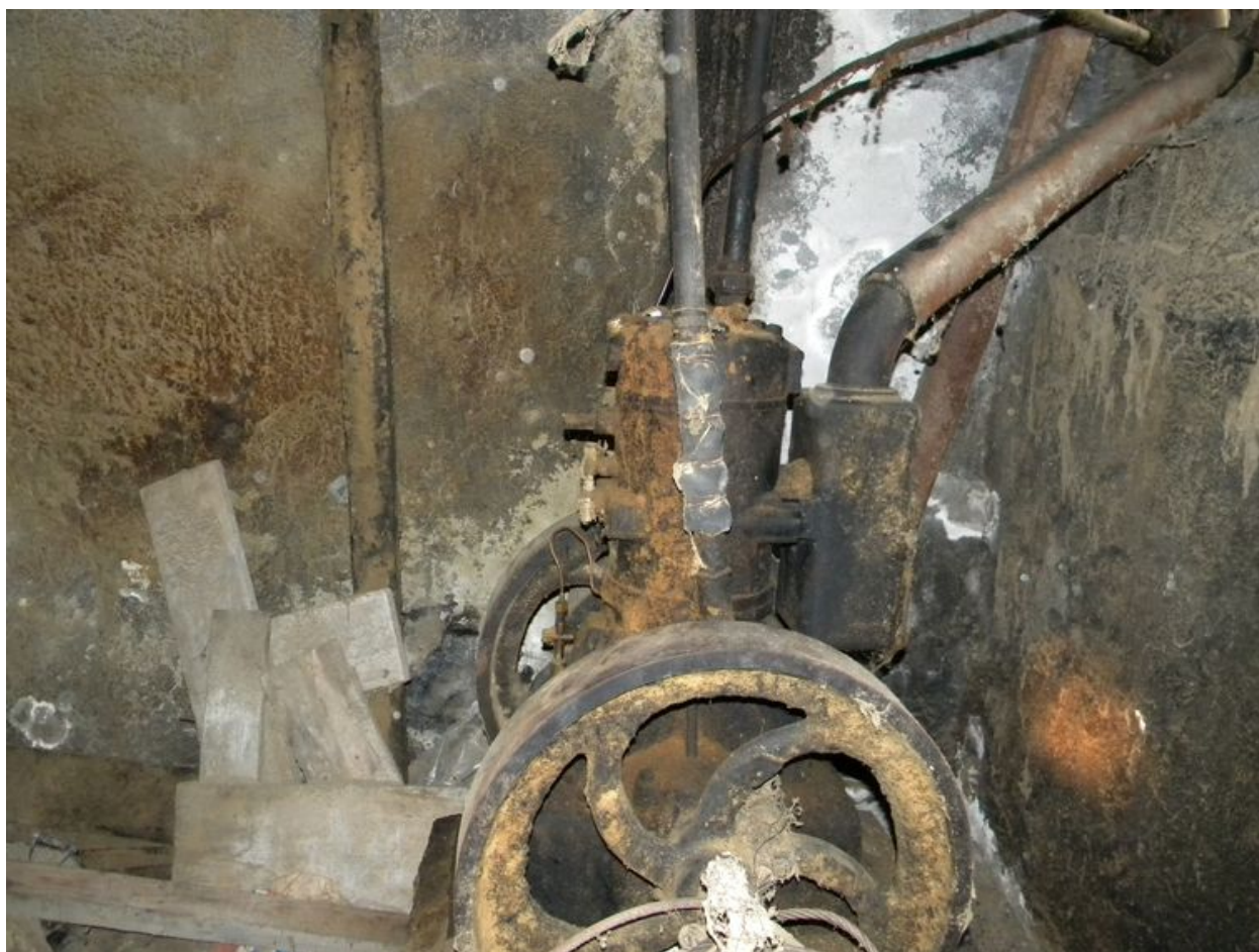
Vue de l'ancien moteur thermique.
