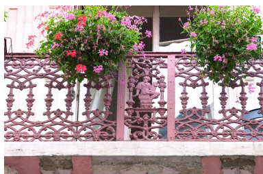
Garde-corps du balcon, troisième étage carré : panneau central orné d'un poète ? Phot. Bernard Ducouret IVR82_20046905231NUCA
