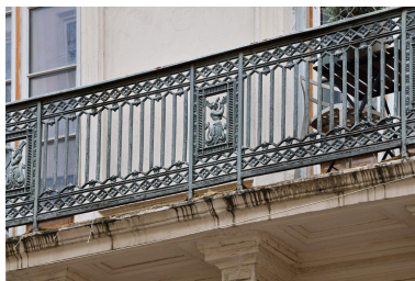
Balcons de la rue de Brest : détail d'un panneau figuré Phot. Thierry Leroy IVR84_20226900497NUCAQ
