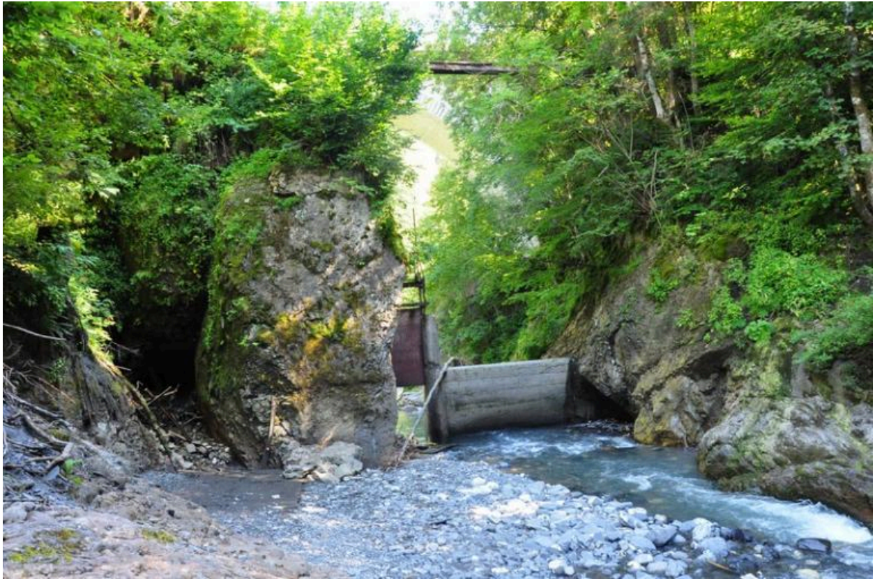
Vue amont de la prise d'eau. A gauche, départ de la dérivation souterraine.
