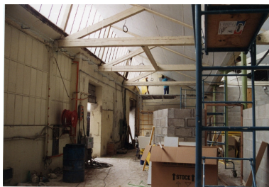
Etat au moment de la réhabilitation en 1994 : charpente en bois. Ecole Emile Cohl Archives privées. Ecole Emile Cohl Repro. Nadine Halitim-Dubois IVR82_20096901547NUCAB
