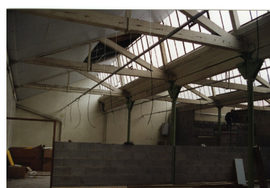
Etat avant réhabilitation : charpente en bois, poteaux fonte, 1994. Ecole Emile Cohl Archives privées. Ecole Emile Cohl Repro. Nadine Halitim-Dubois IVR82_20096901542NUCAB
