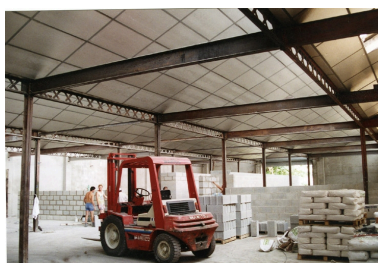
Etat au moment de la réhabilitation en 1994 : structure métallique conservée. Ecole Emile Cohl Archives privées. Ecole Emile Cohl Repro. Nadine Halitim-Dubois IVR82_20096901544NUCAB
