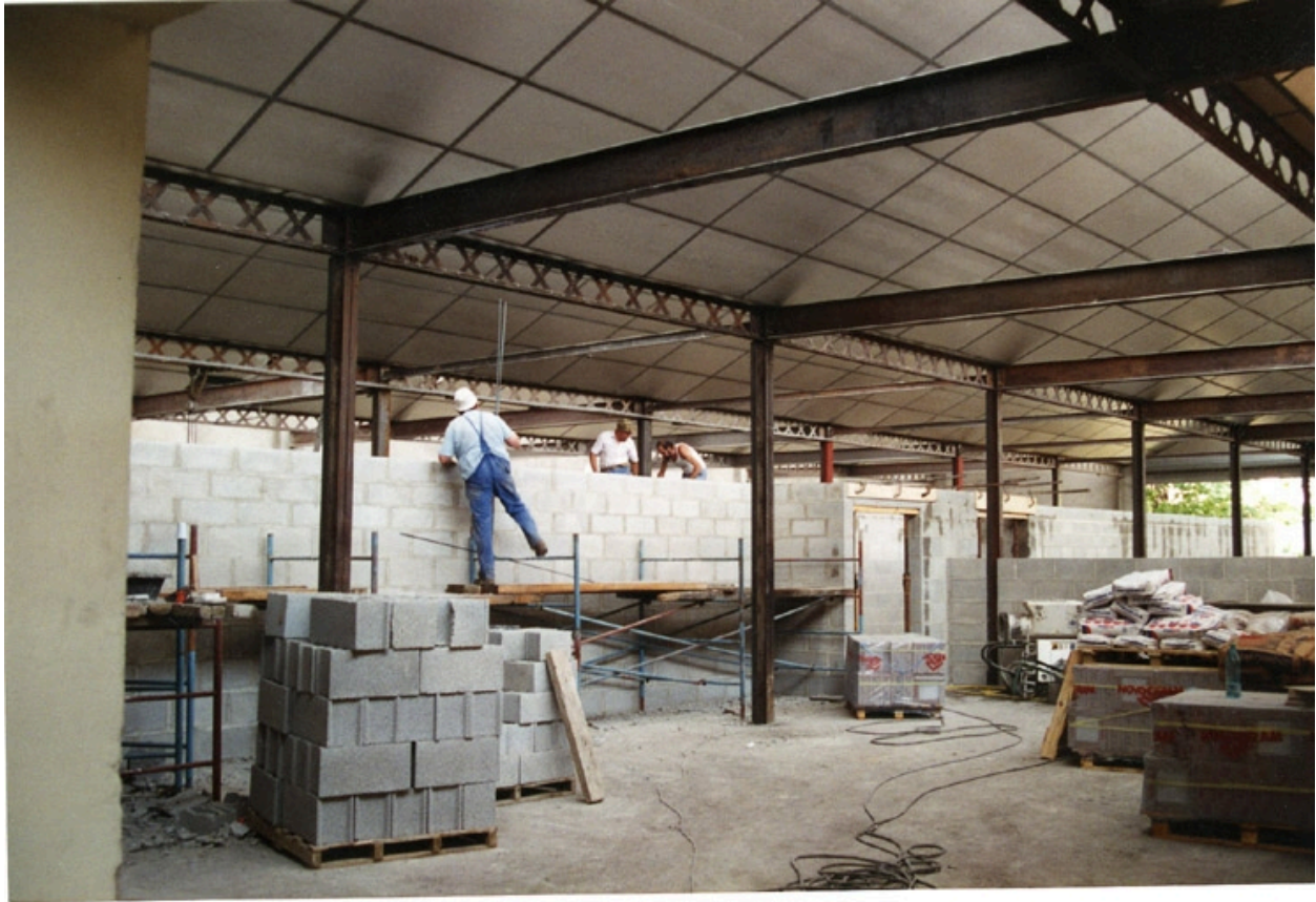
Travaux au moment de la réhabilitation du site 1994. Ecole Emile Cohl Archives privées. Ecole Emile Cohl
