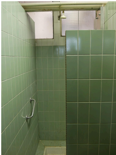
Détail cabine douche Phot. Nadine Halitim-Dubois IVR84_20256902093NUCA
