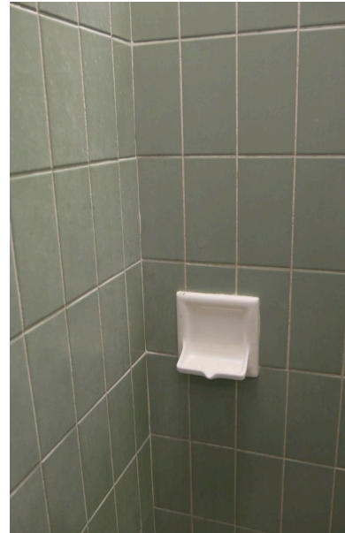
Détail cabine douche Phot. Nadine Halitim-Dubois IVR84_20256902092NUCA
