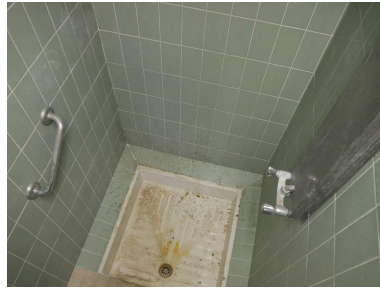
Détail cabine douche Phot. Nadine Halitim-Dubois IVR84_20256902091NUCA
