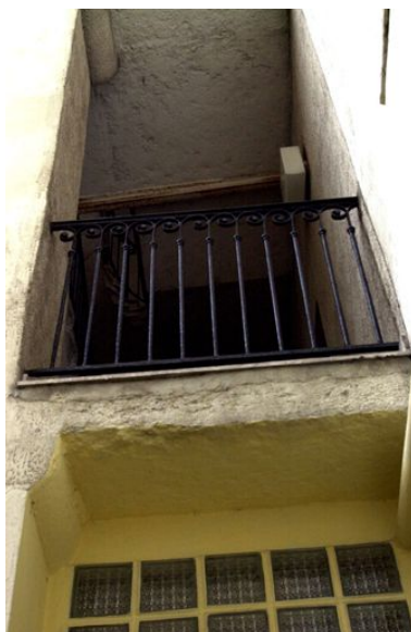
Détail de la cage d'escalier ouverte et de son garde-corps Phot. Maryannick Chalabi IVR82_20016900122NUCA
