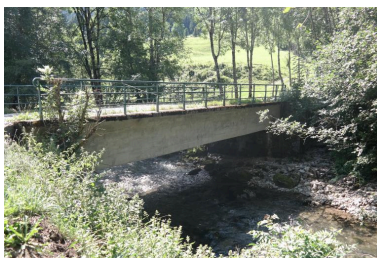
Vue générale du pont de Passengué, face aval Phot. Pascale Renard IVR84_20197401203NUCA
