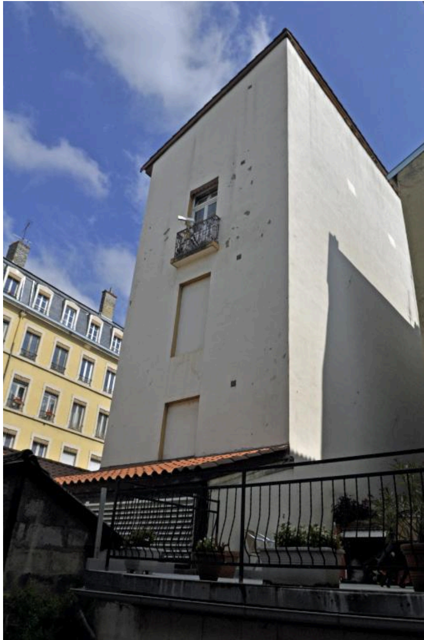
Elévations latérale et postérieure du retour du L, couvert à un pan
