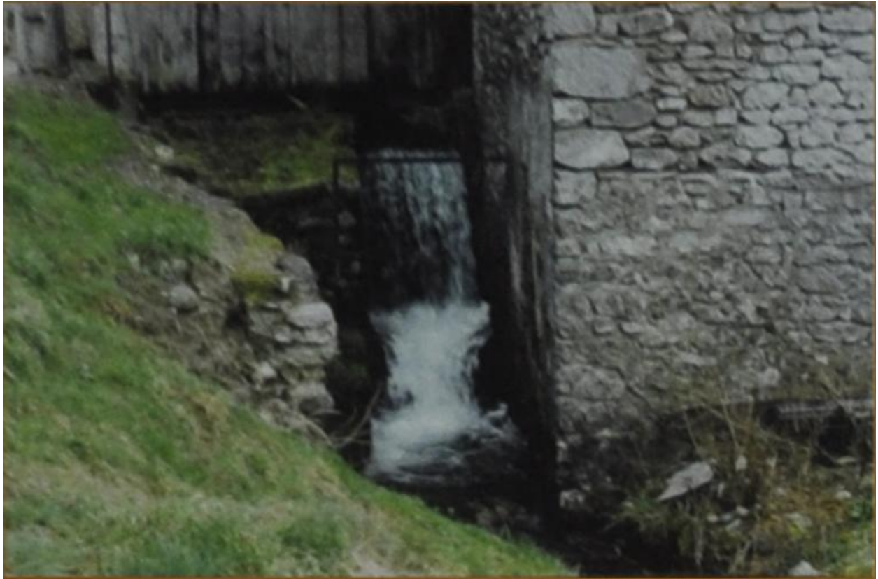
Canal de dérivation alimentant la turbine de la diamanterie
