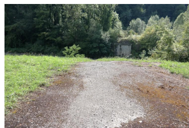
Ancien pont de la Douceur, vue de l'ancienne chaussée en rive droite et de la culée en rive gauche Phot. Pascale Renard IVR84_20207401616NUCA
