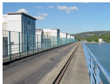
Barrage et chaussée du pont routier, face aval (depuis la rive gauche) Phot. I. Havard IVR82_20102600090NUCA
