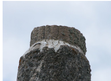
Détail du sommet du fût avant restauration. Phot. Thierry Monnet IVR82_20124202935NUCA
