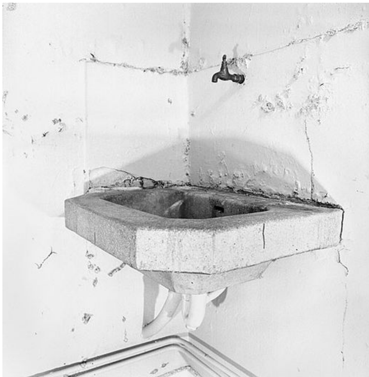
Lavabo, corps de bâtiment central, deuxième étage
