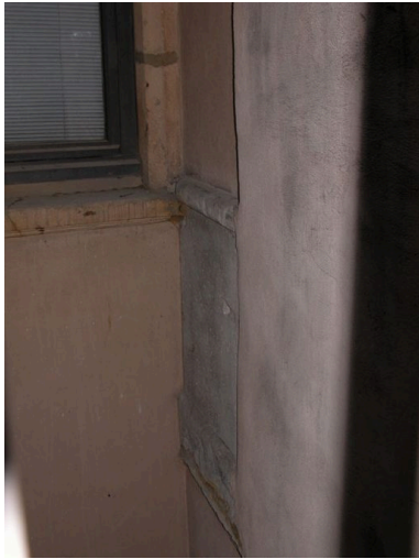
Détail d'un garde-corps de la galerie nord fermée Phot. David Chevallier IVR82_20046905086NUCA
