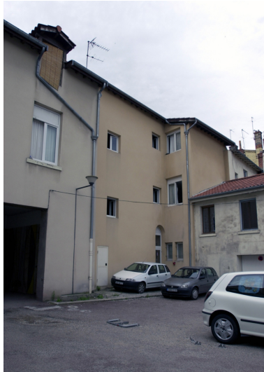
Élévation postérieure, vue partielle (à gauche de l'image) Phot. Maryannick Chalabi IVR82_20126903083NUCA
