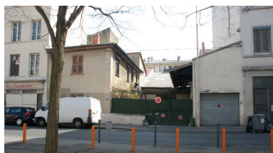
Maison démolie au 41 rue Sébastien- Gryphe (vue prise en 2012) Phot. Catherine Guégan IVR82_20136900107NUCA
