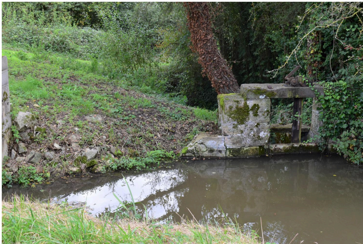
Étang : vue d'une vanne.
