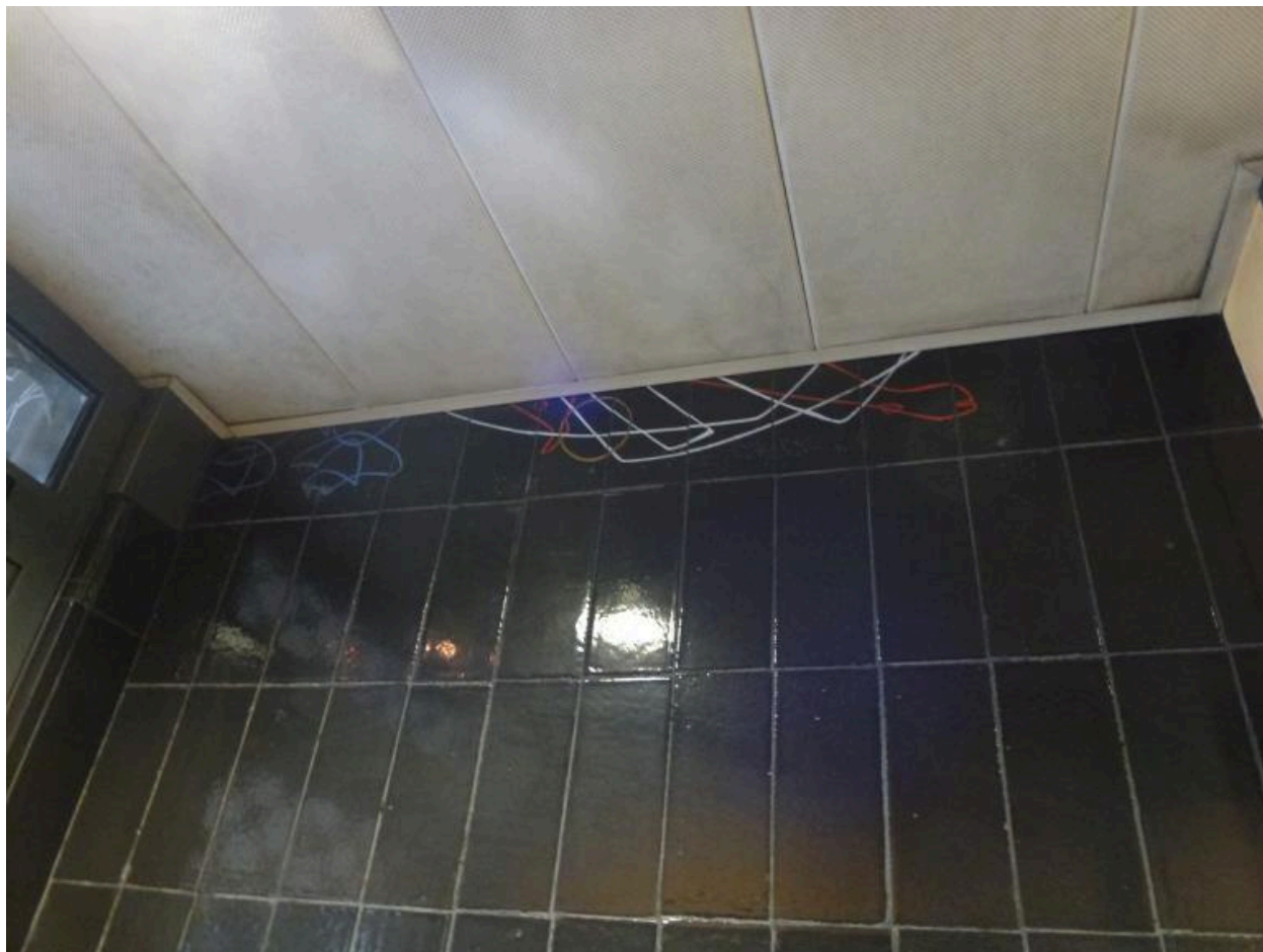
Faux-plafond du hall d'entrée masquant une partie de la frise située à l'est de la banque d'accueil.
