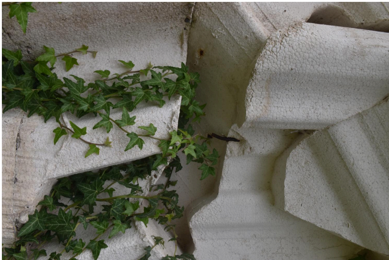
Détail avec fixation métallique apparente, oxydée
