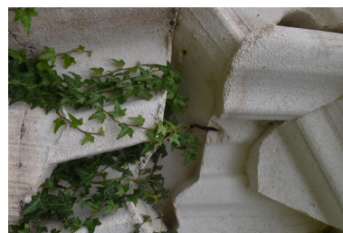
Détail avec fixation métallique apparente, oxydée Phot. Catherine Guégan IVR84_20240300376NUCA
