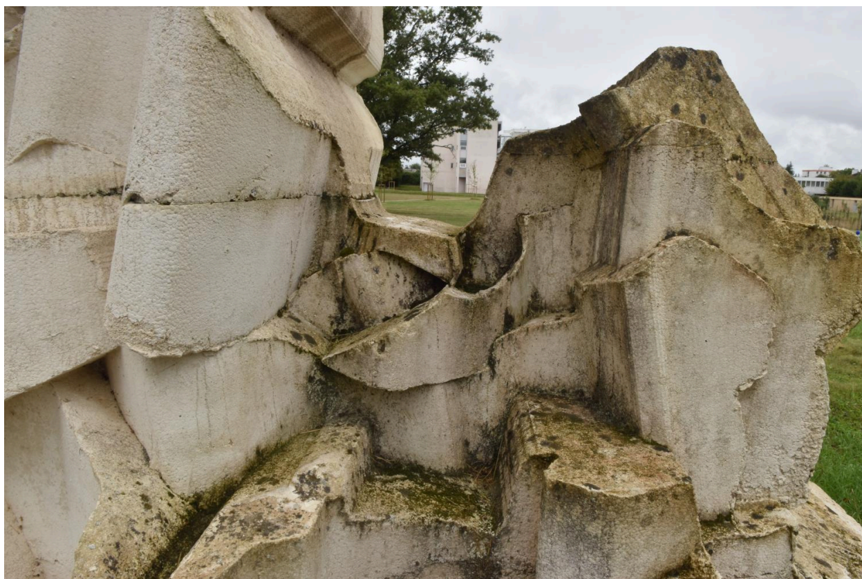
Détail des altérations : mousses, coulures
