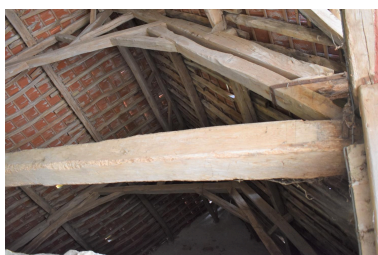
Détail de la charpente au nord de la grange à auvent. Phot. Maryse Durin-Tercelin IVR84_20250300577NUC4A
