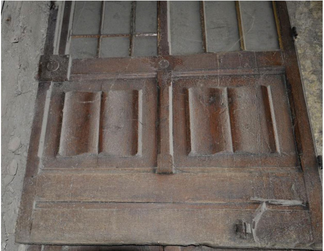
Vantaill de la porte de la galerie déposé dans la cave, détail
