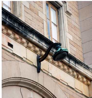
Luminaire en applique, corps de bâtiment principal, côté cour Phot. Catherine Guégan IVR82_20146902507NUCA
