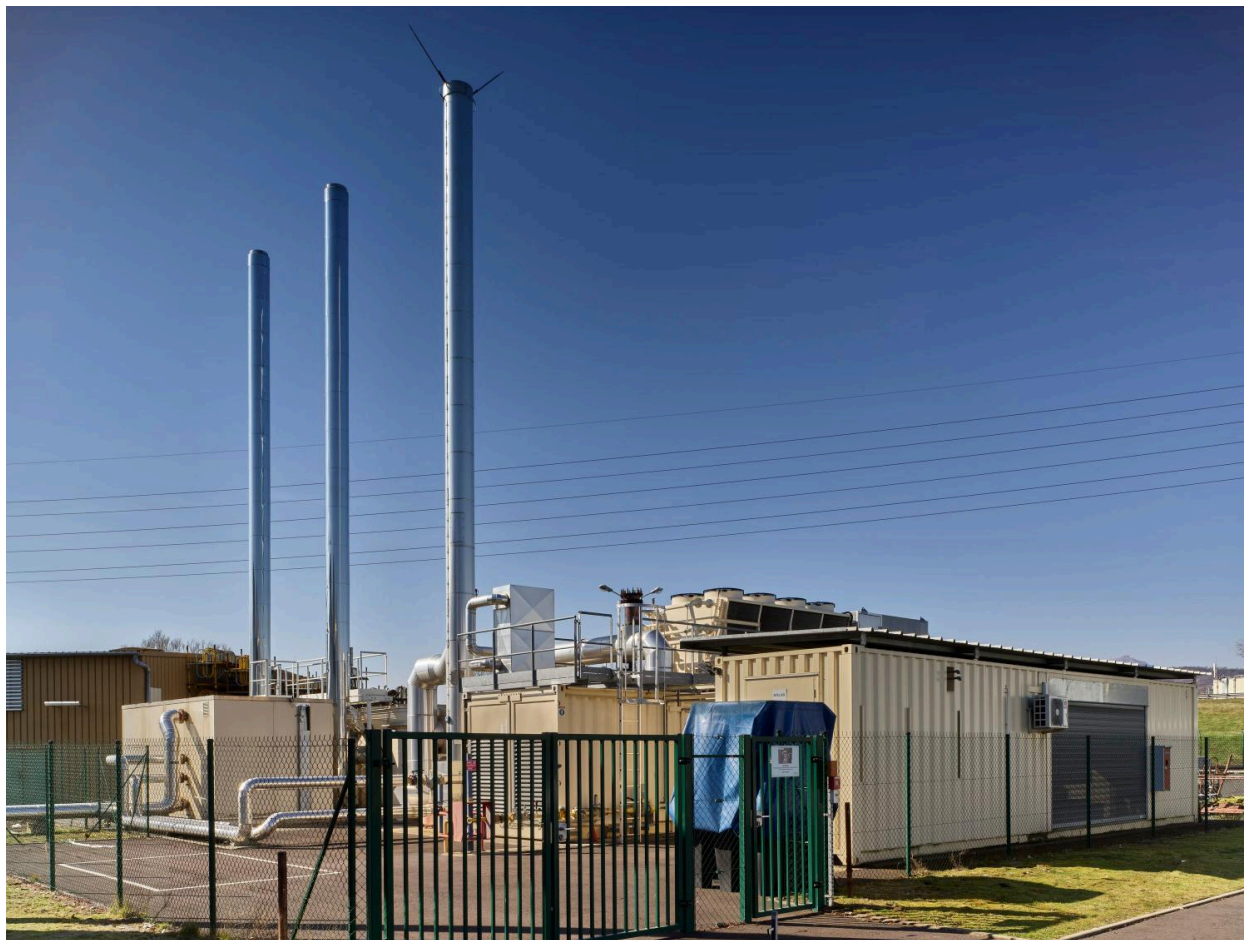
La chaufferie de Chantemerle (B147), à l'ouest du site.
