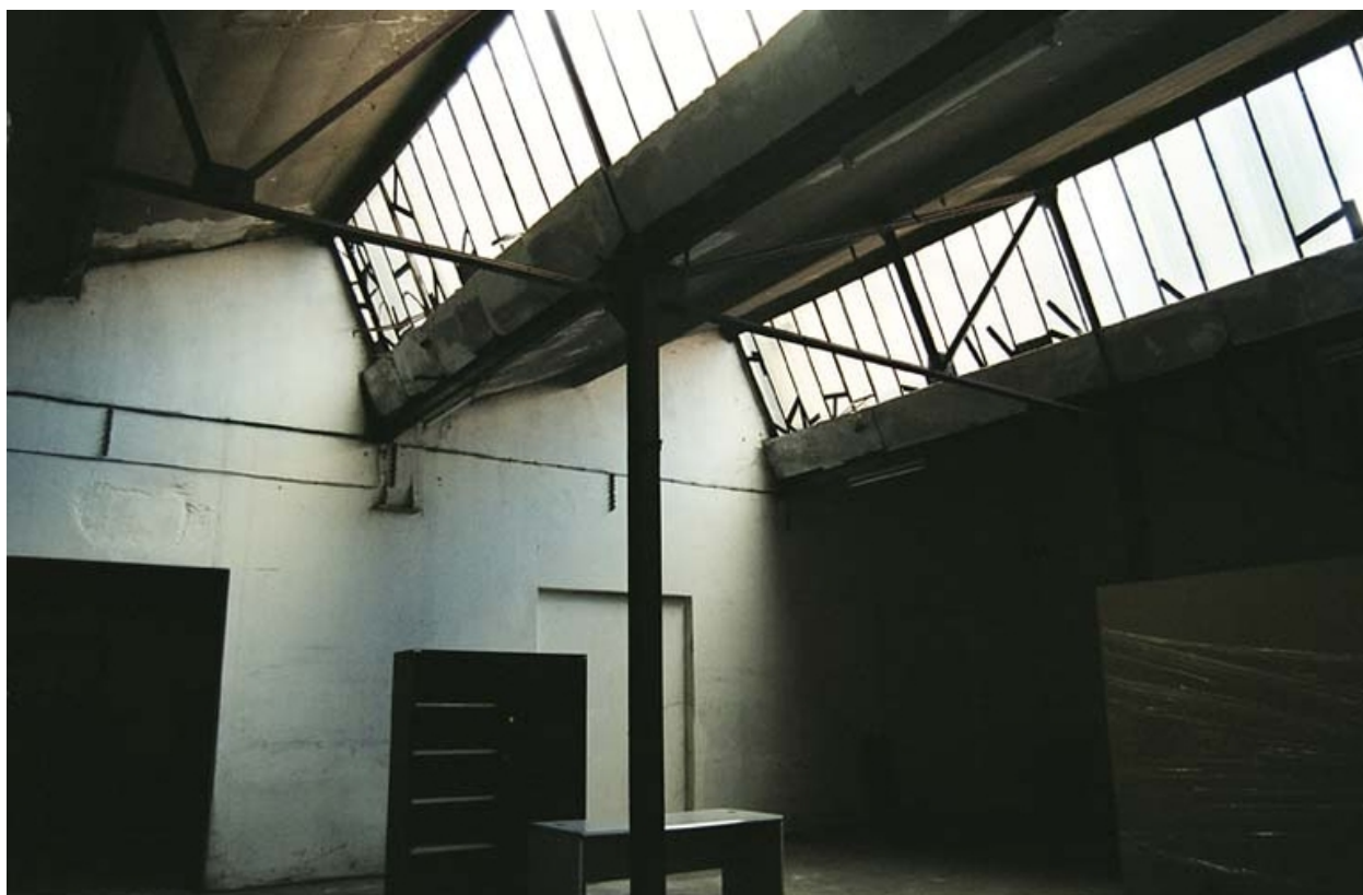
Intérieur des ateliers
