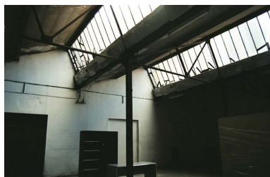
Intérieur des ateliers Phot. Nadine Halitim-Dubois IVR82_20036901829ZA
