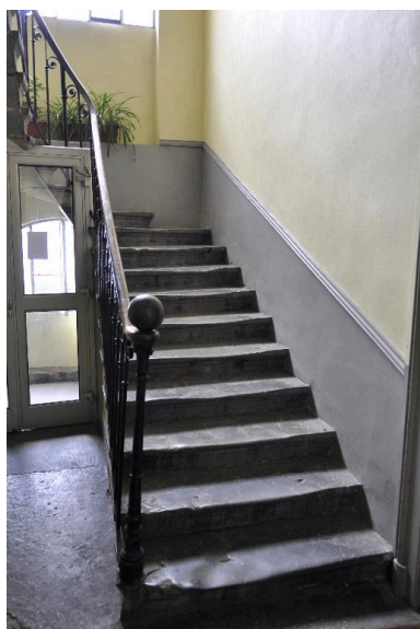
Vue intérieure : le départ de l'escalier, sur le palier du premier étage Phot. Catherine Guégan IVR84_20166900754NUCA
