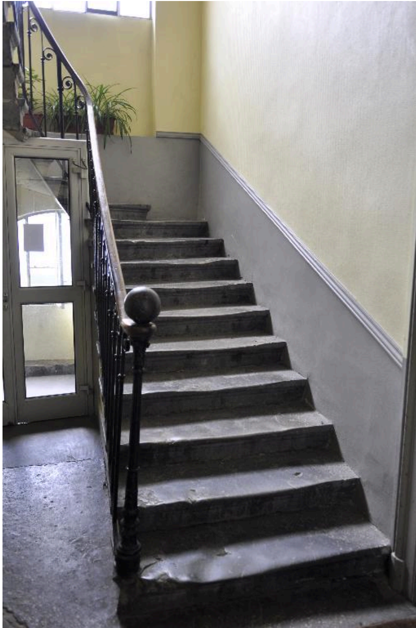
Vue intérieure : le départ de l'escalier, sur le palier du premier étage
