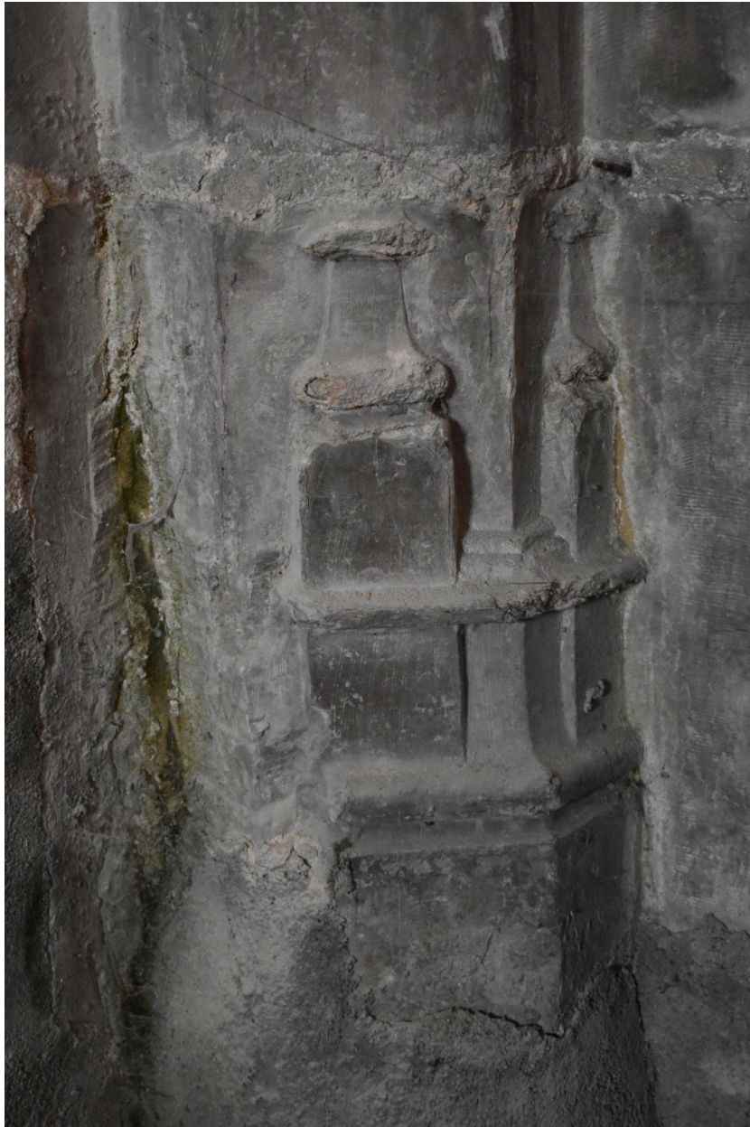
Détails des bases d'arcs et nervures à l'angle nord-est de la chapelle de la Beaume.
