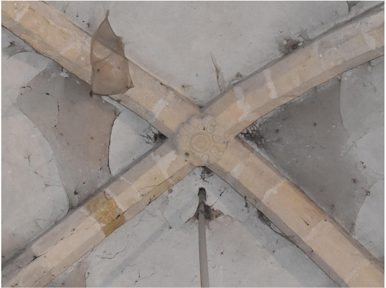
Détail de la croisée d'ogives à clef de voûte ornée d'une rosace de la travée d'avant chœur.
