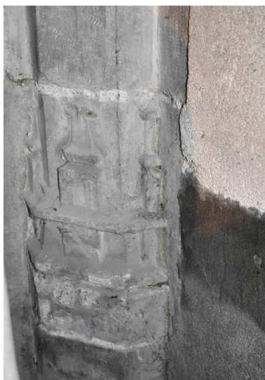
Détails des bases d'arcs et nervures à l'angle nord-ouest de la chapelle de la Baume. Phot. Maryse Durin-Tercelin IVR84_20250300132NUCA
