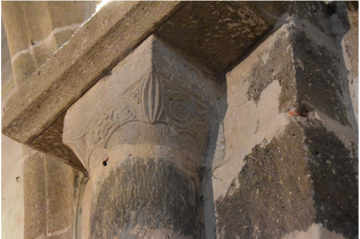
Chapiteau roman sculpté de motifs géométriques à la retombée nord de l'arc doubleau brisé limitant la première travée et la seconde travée de la nef, vu de trois quart.
