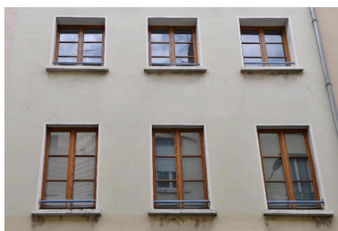
Vue rapprochée de l'élévation sur rue : différence de gabarit des baies du premier et du deuxième étages Phot. Magali Delavenne IVR84_20176901048NUCA
