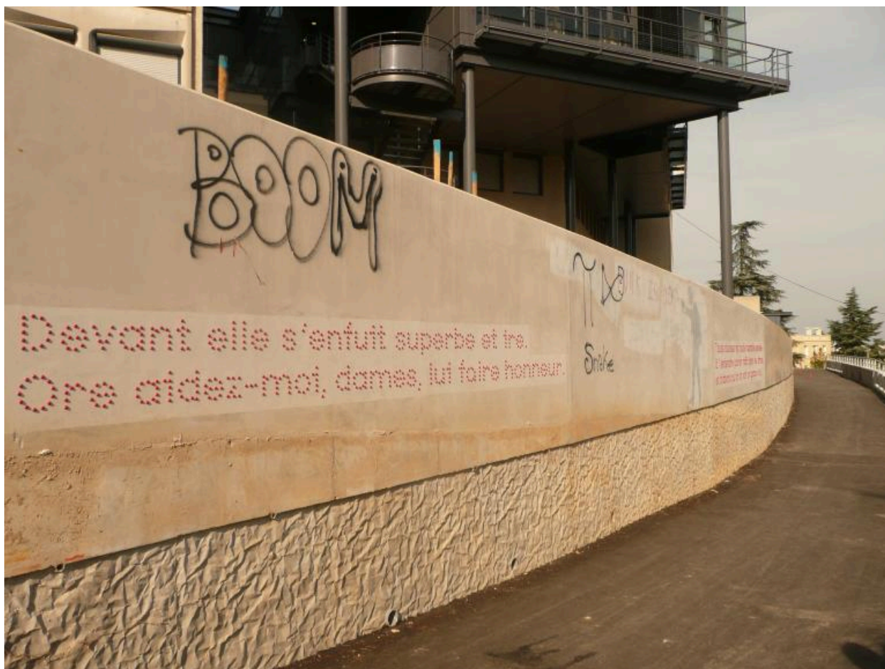
Citation n° 2 et vue d'ensemble du mur de soutènement (état 2007).
