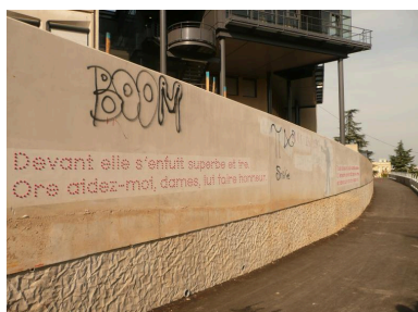
Citation n° 2 et vue d'ensemble du mur de soutènement (état 2007). Autr. auteur inconnu IVR84_20206900709NUCAB
